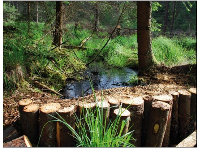
Abb. 8: Das Verschließen der Entwässerungsgräben führt zur Wiedervernässung der Flächen und ist Voraussetzung für die Wiederentwicklung der ehemaligen Moorwälder. Fotos: R. Ulrich, V. Wild, R. Wirtz; Karte: V. Wild
